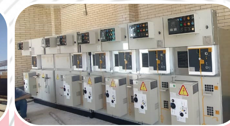
نصب تابلوهای کوبیکل پست پاساژ
