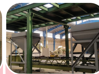
نصب شوت‌ها و تجهیزات سیستم توزین
